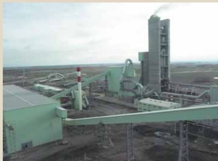
6 августа 2010 года состоялся торжественный пуск Пятой технологической линии по производству цемента ОАО «Сухоложскцемент». Строители УММ 2 приступили к монтажу Пятой технологической линии ОАО «Сухоложскцемент» в октябре 2007 года, начав с дробильного отделения. Работая в круглосуточном режиме, за два месяца они установили более 500 тонн тяжеловесного оборудования, были смонтированы цементные мельницы весом 200 и 240 тонн, вращающаяся печь общим весом 420 тонн, дымовая труба внутри железобетонного пилона и другие объекты комплекса. В течение всего проекта строителями специалисты УММ 2 смонтировали около 5 300 тонн технологического оборудования, в том числе 1000 тонн нестандартного, более 1200 тонн различных металлоконструкций, общая длина трубопроводов составила 6 500 метров, а протяженность конвейеров и элеваторов — более 1 500 метров.
